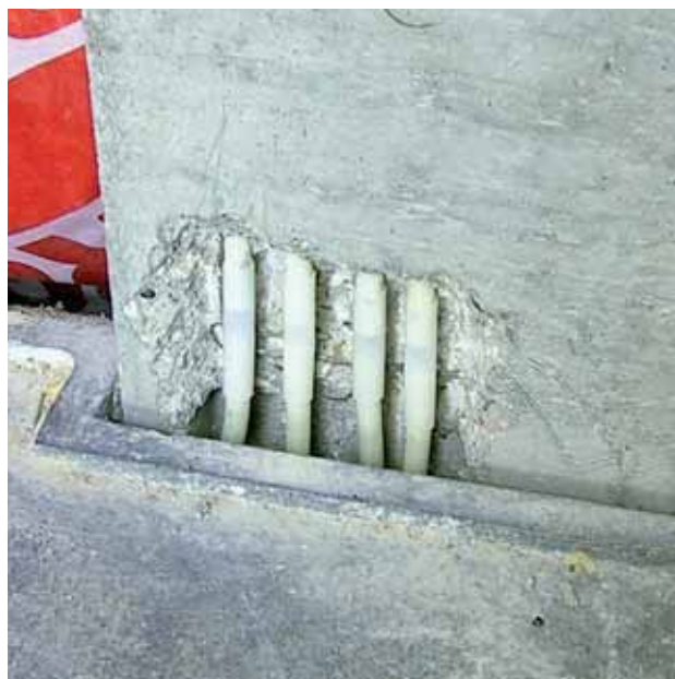
Figur 40. Rørføring mellem 2 elementer i en trapperums-væg ud for etageadskillelsen. Rørføringen, som er udført med flexrør, er delvis skjult af trappereposen. Den udsparring, der har været ved rørenes udmundning har tydeligvis ikke været stor nok. Det har været nødvendigt at hugge yderligere ud omkring rørene. Det vil kræve stor omhu at lave en pæn udstøbning omkring rørene bag reposen.
