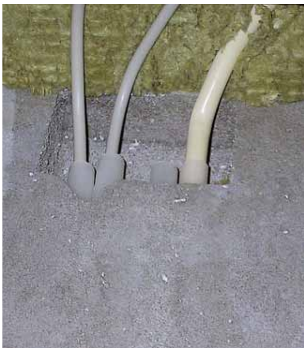
Figur 38. Fremføring af ledninger og kabler frem til det enkelte element kan udføres ved hjælp af kabler eller som lukket rørinstallation. Hvilken løsning der vælges vil være projektafhængig.
